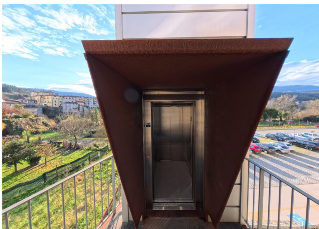
28 Ascensore che collega parcheggio Teatro – rampa
